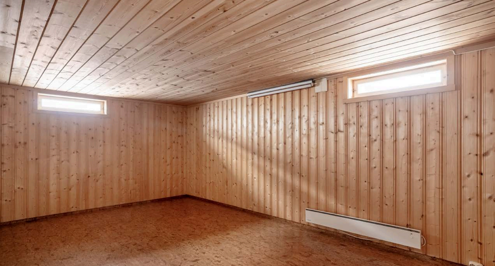
Rom i kjeller innredet som kjellerstue nr 2. Det gjøres oppmerksom på at rommet ikke er godkjent for varig opphold.
