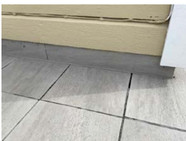
Stengt lufting i nedkant av kledning
