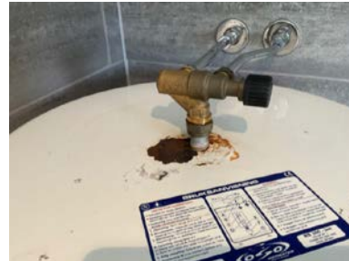
Rust på VV bereder.
