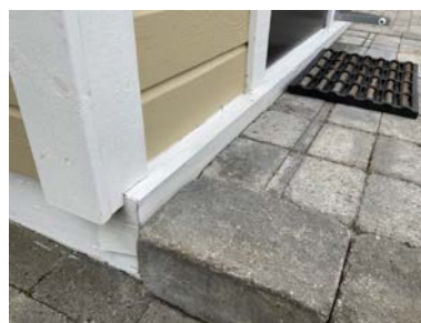
Stengt lufting i nedkant av kledning
