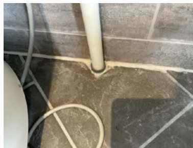
Manglende mansjett rundt rørgjennomføring.
