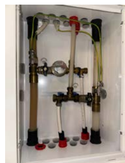
Samleskap med rørkurser og stoppekraner
