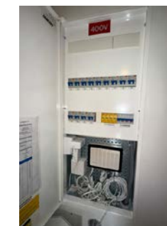
Sikringskap med automatsikringer.
