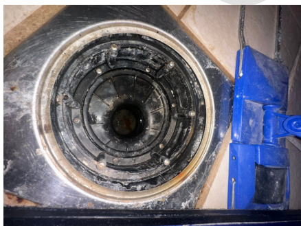
Sluk i plast, plassert på vaskerom
