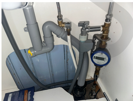
Rørøpplagg på kjøkken
