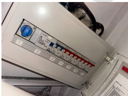
Sikringsskap med automatsikringer.
