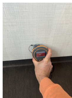
Fuktmåling med forhøyede resultater
