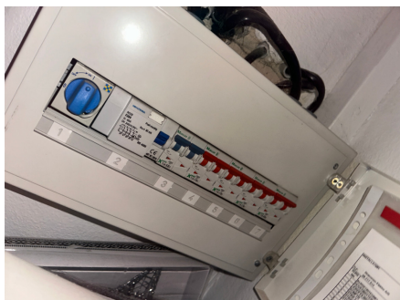
Sikringsskap med automatsikringer.
