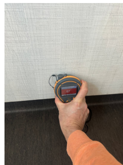
Fuktmåling med forhøyede resultater
