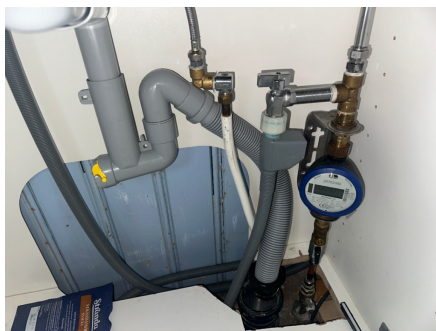
Rørøpplagg på kjøkken
