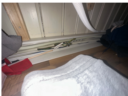
Manglende deksel, k-rør
