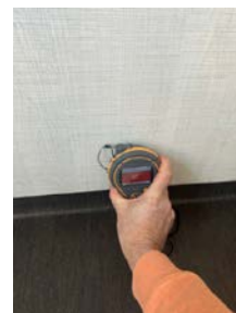
Fuktmåling med forhøyede resultater
