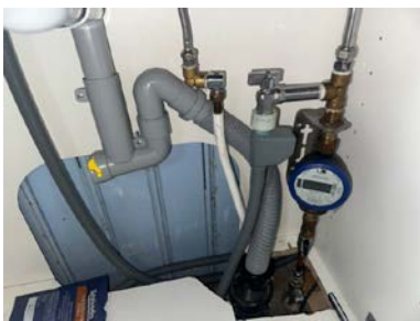
Røropplegg på kjøkken
