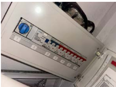
Sikringsskap med automatsikringer.
