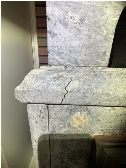
Viser sprekk i stein.
