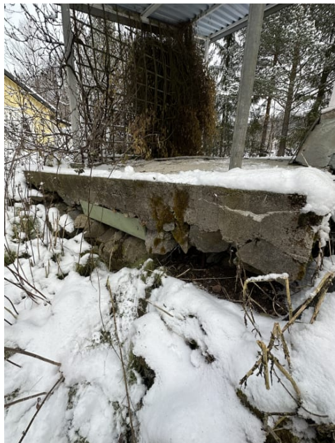
Sviktende takkonstruksjon på carport som følge av sviktende grunn/fundamentering.
