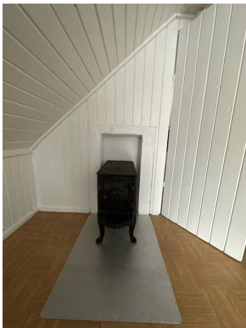
Viser vedovn i 2.etasje. Ikke synlig pipevange i 2. Etasje.
