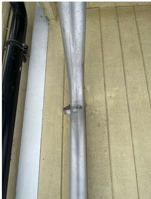
Nedløpsrør er ikke tilstrekkelig festet.
