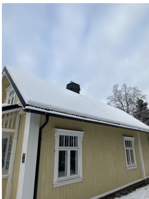
Taktekkingen er ikke besiktiget grunnet snø. Anbefaler ytterligere undersøkelser når forholdene gjør det mulig.
