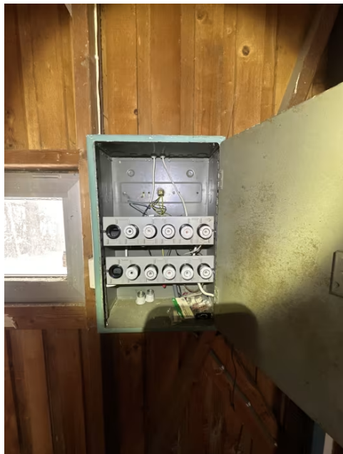
Viser sikringskap med fem skrusikringer i uthus.
