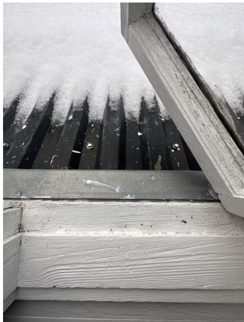
Viser glippe mellom vannbrett og vindu i 2.etasje. Utbedring må påregnes.
