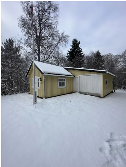
Viser uthus/garasje med oppgradering, vedlikehold og moderniseringsbehov.
