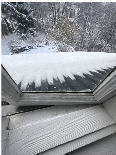
Viser kondensskader rundt glass.
