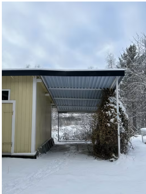
Viser skjevhet på takkonstruksjon ved carport.
