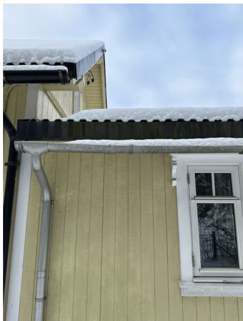
Viser motfall/ skjevhet på takrenne.
