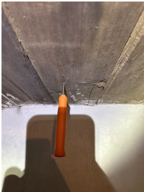
Viser råteskader i stubbloft. Anbefaler ytterligere undersøkelser bak kledning.
