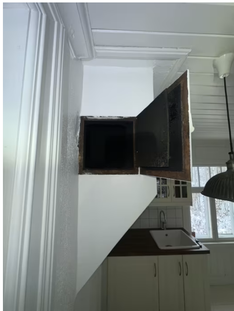
Sotluke plassert i kjøkken.
