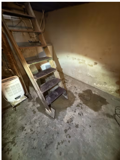
Fritt vann registrert i kjeller.
