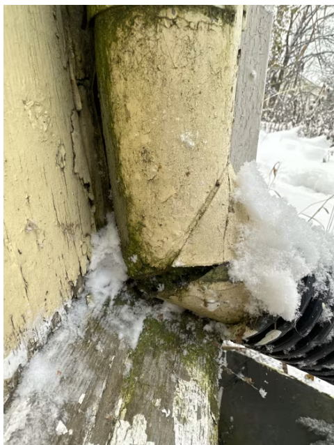
Viser sprukket utkast på vestsiden av boligen.
