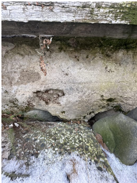
Viser avskalling av puss på grunnmur.
