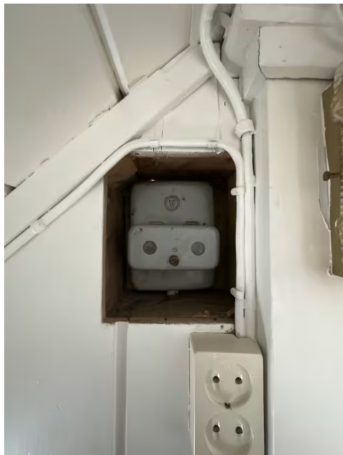
Inntakboks med hovedsikringer plassert i trapperom 2. Etasje.
