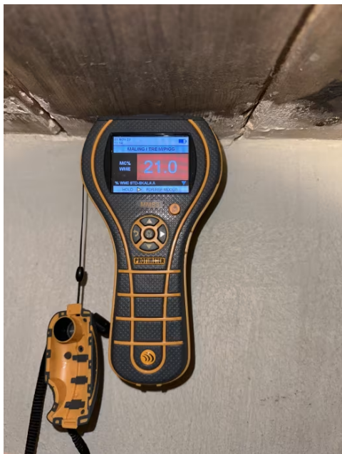
Viser forhøyede fuktverdier.
