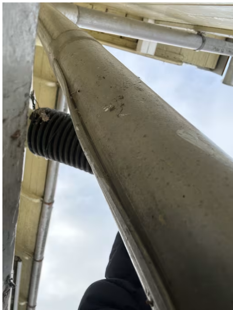
Registrert frostspreng på enkelte nedløp.
