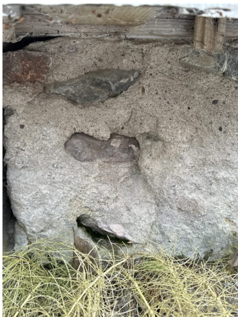
Viser avskalling av puss på grunnmur.
