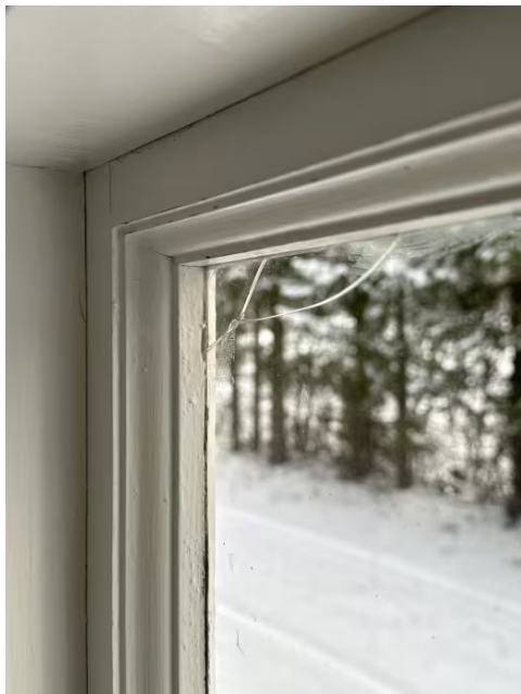
Viser sprekk i glass.
