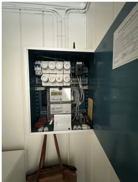
Sikringsskap plassert trapperom 1. Etasje.
