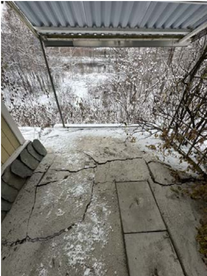
Viser sprekk setninger ved støpt såle i carport.
