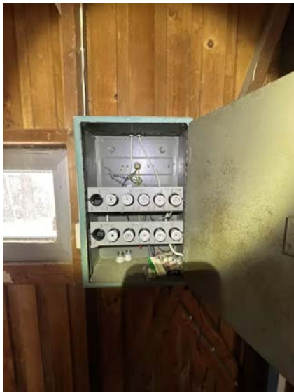
Viser sikringskap med fem skrusikringer i uthus.
