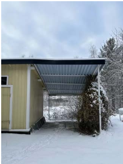
Viser skjevhet på takkonstruksjon ved carport.
