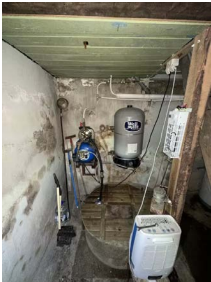
Viser brønn med hydroforanlegg, vannpumpe, hovedstoppekran og trykktank.
