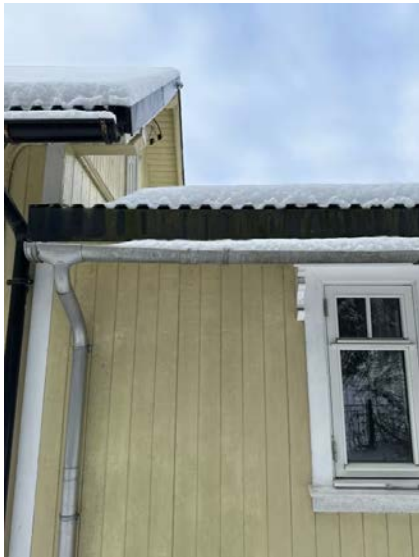
Viser motfall/ skjevhet på takrenne.
