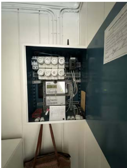
Sikringskap plassert trapperom 1. Etasje.
