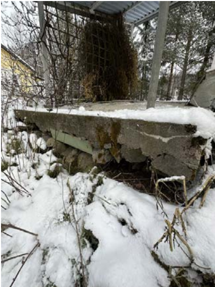
Det registrert setninger, sviktende fundamentering til carport. Støpte fundamenter tilknyttet carport anbefales reetablert.
