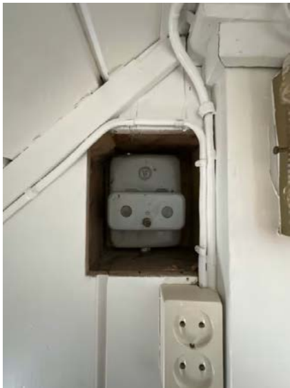
Inntakboks med hovedsikringer plassert i trapperom 2. Etasje.
