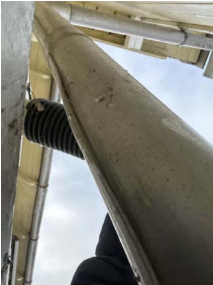
Registrert frostspreng på enkelte nedløp.
