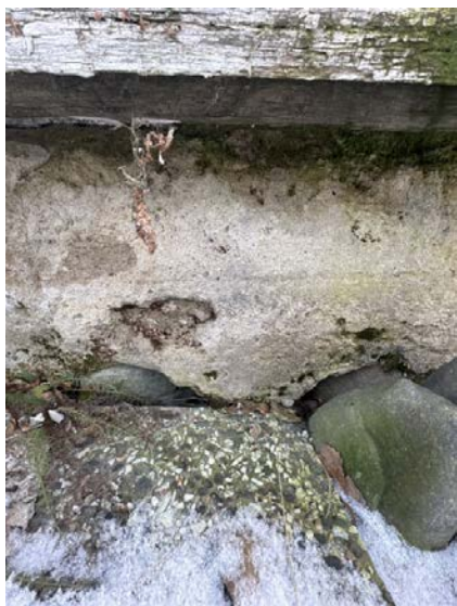
Viser avskalling av puss på grunnmur.
