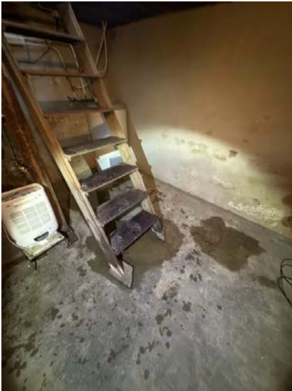
Fritt vann registrert i kjeller.
