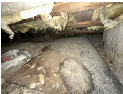
Begrenset besiktigelse av kryptjeller. Isolasjon og bjelkelag er eksponert for fukt. Plater mellom
