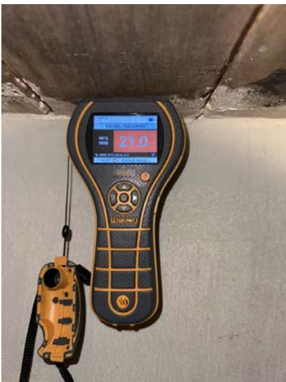
Viser forhøyede fuktverdier.
