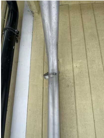
Nedløpsrør er ikke tilstrekkelig festet.
