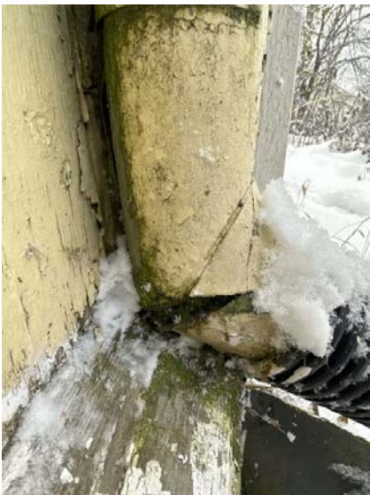
Viser sprukket utkast på vestsiden av boligen.
