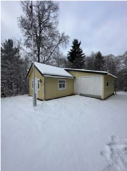
Viser uthus/garasje med oppgradering, vedlikehold og moderniseringsbehov.
