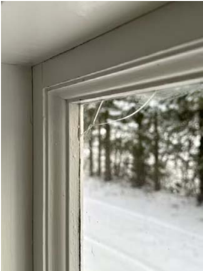
Viser sprekk i glass.
