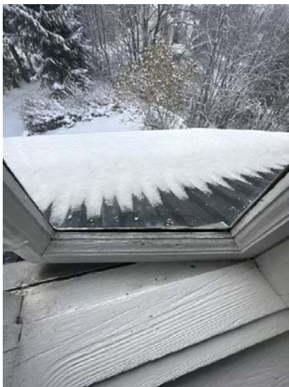
Viser kondensskader rundt glass.
