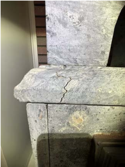
Viser sprekk i stein.
