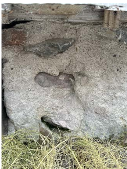
Viser avskalling av puss på grunnmur.
