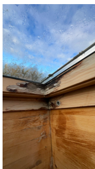
Råteskade på det store takvinduet.
