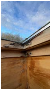
Råteskade på det store takvinduet.
