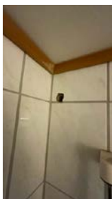
Avløpsrør høyt på vegg i dusjsone.
