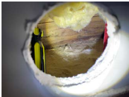
Misfarging på rupanel mot dusjsone på bad.
