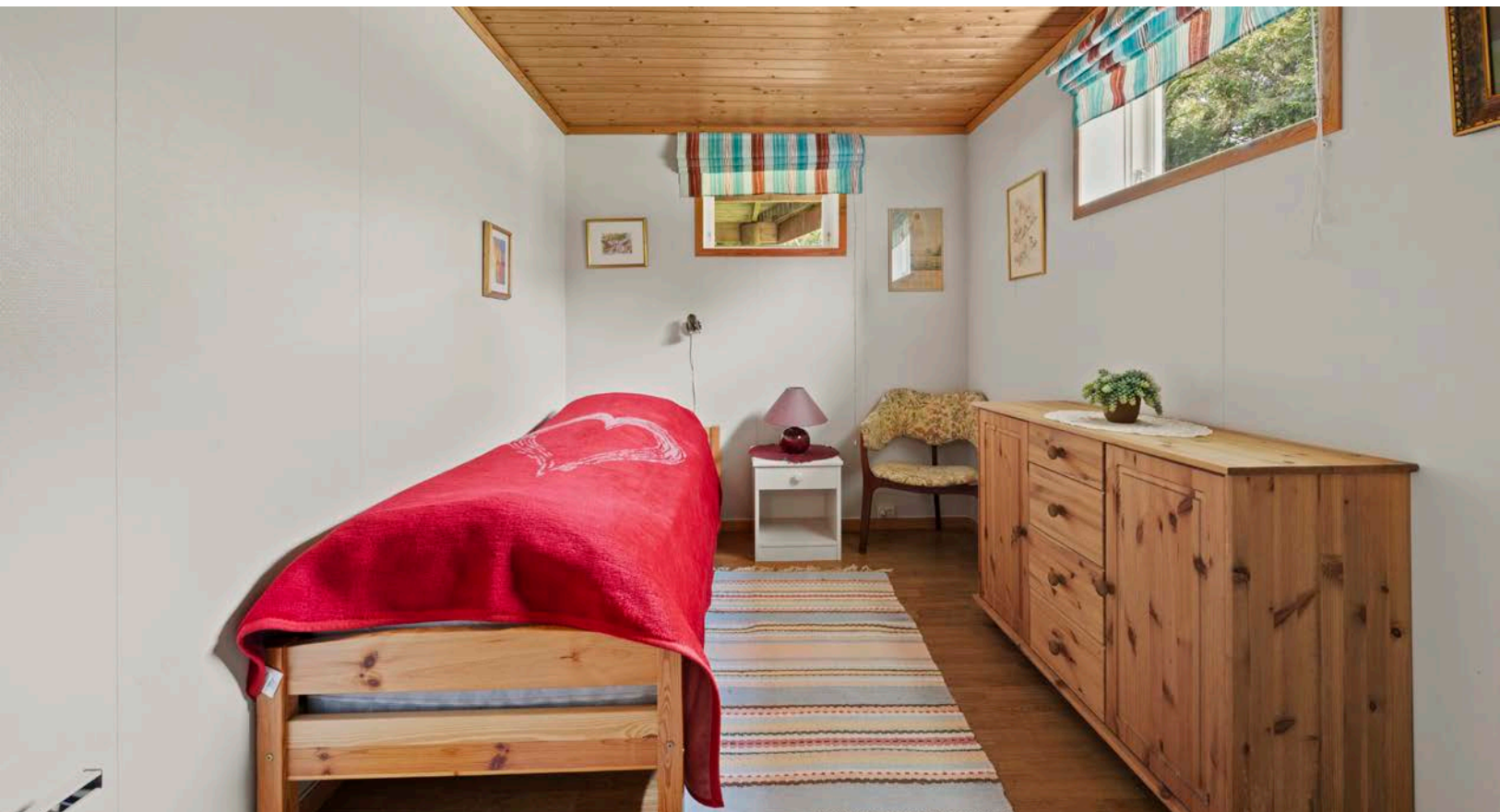
Ett av tre rom innredet som soverom i underetasjen (ikke byggesøkt og ikke godkjent rømningsvei)
