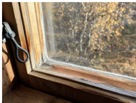
Slitasje på vinduer
