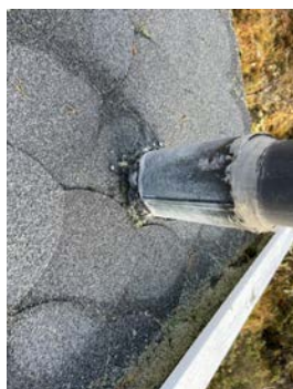
Bør monteres beslag ved lufferør og pipe
