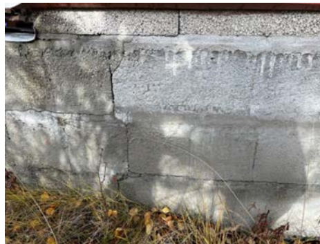
Ufagmessig utførelse av grunnmur
