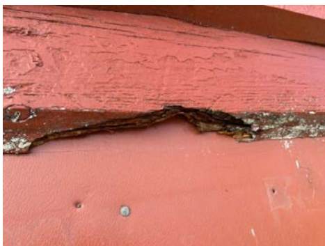
Råte stedvis i kledning
