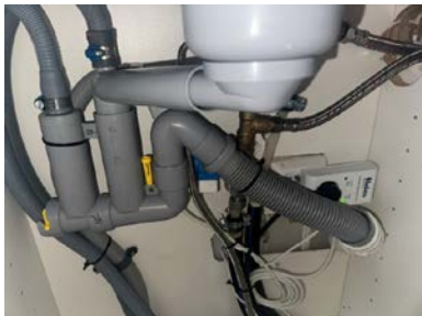
Rørøpplagg i kjøkkenbenk med Waterguard
