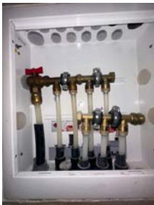
Samleskap med rørkurser og stoppekraner
