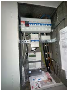
Sikringsskap med automatsikringer.
