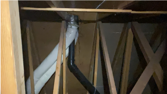
Fuktskjolder ved gjennomføring/lufting.
