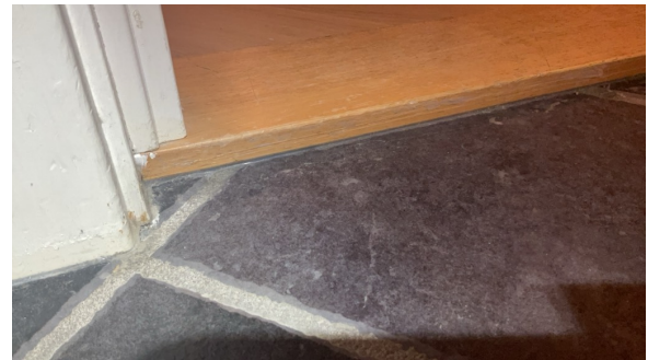
Ingen synlig oppbrett av membran ved terskel.
