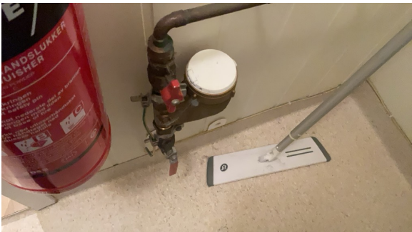
Stoppekran plassert på teknisk rom/bod.
