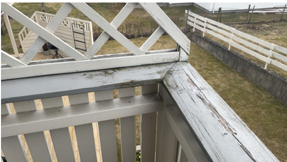
Slitasje på håndløper.
