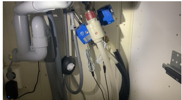
I kjøkkenskap er det ikke tett tilslutning mellom varerør og innerrør for rør i rør system.
