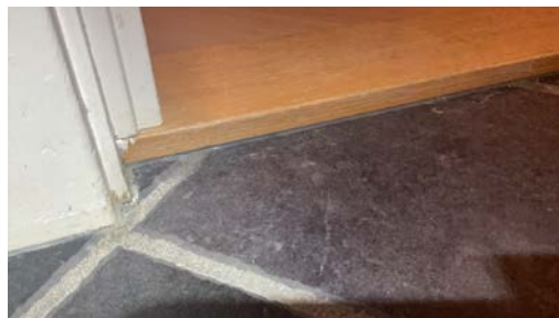
Ingen synlig oppbrett av membran ved terskel.
