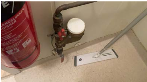
Stoppekran plassert på teknisk rom/bod.
