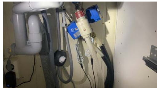
I kjøkkenskap er det ikke tett tilslutning mellom varerør og innerrør for rør i rør system.
