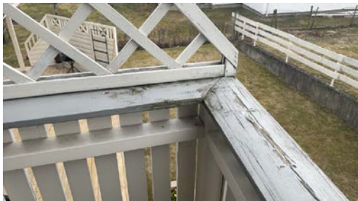
Slitasje på håndløper.
