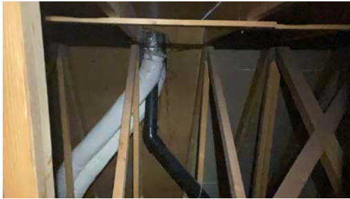
Fuktskjolder ved gjennomføring/lufting.
