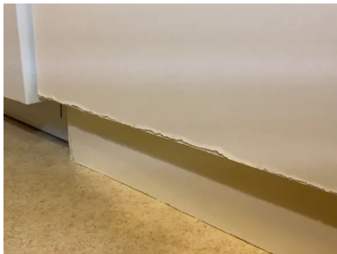
Skade på innrdning.
