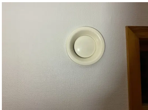
Ventil i vegg på stue.
