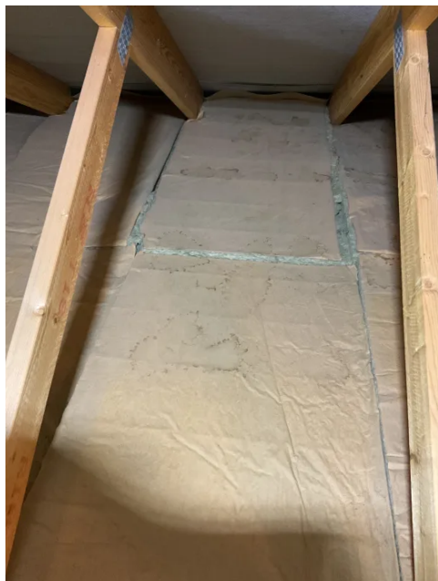
Fuktskjolder på isolasjonsplater.
