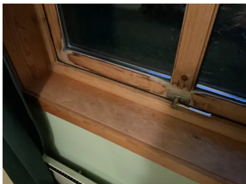
Fuktmerker i karmen.
