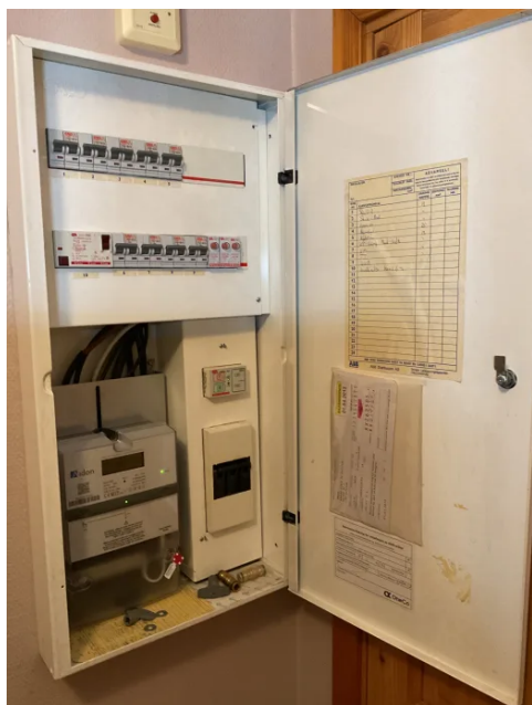
Sikringsskap i gang.
