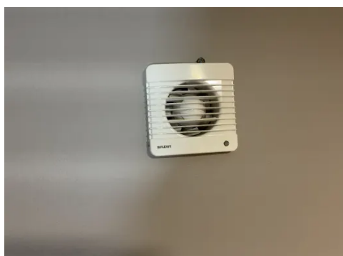
Avtrekksvifte på bad.
