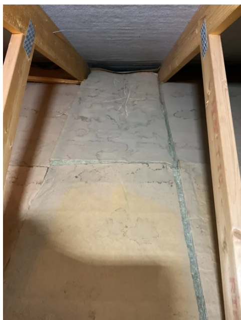
Fuktskjolder på isolasjonsplater.
