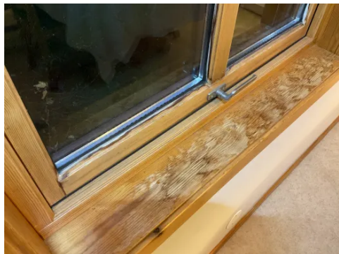
Fuktmerker i karmen.
