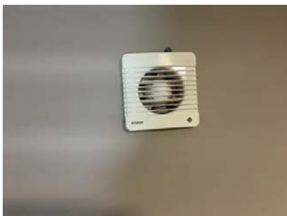
Avtrekksvifte på bad.
