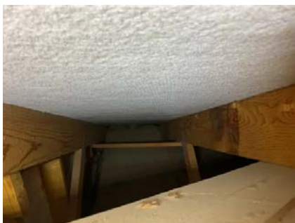
Redusert lufting i raft.
