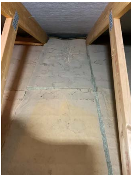
Fuktskjolder på isolasjonsplater.
