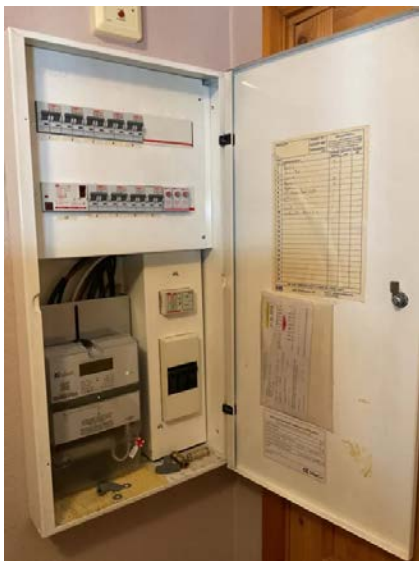
Sikringsskap i gang.
