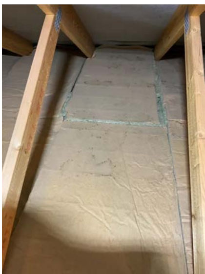
Fuktskjolder på isolasjonsplater.
