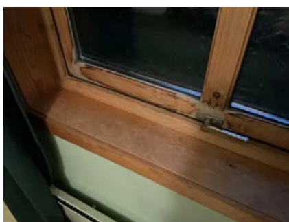
Fuktmerker i karmen.
