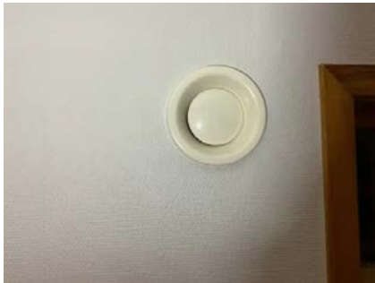
Ventil i vegg på stue.
