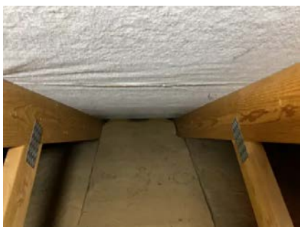
Redusert lufting i raft.
