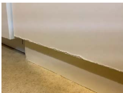
Skade på innrdning.
