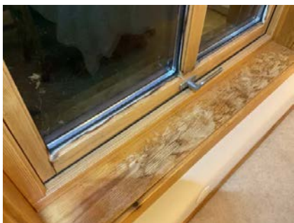
Fuktmerker i karmer.
