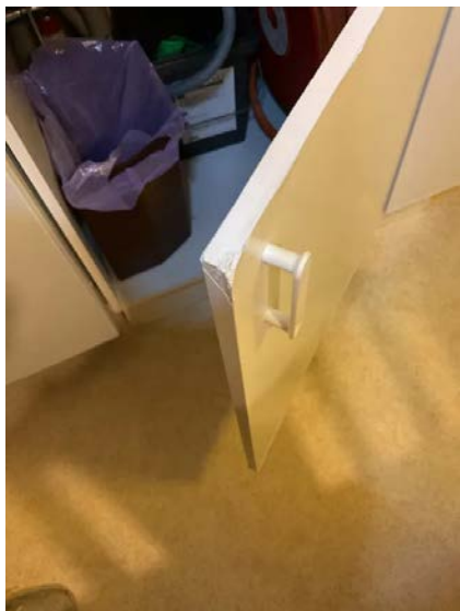
Skade på innrdning.
