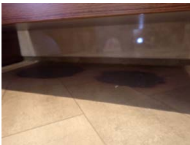
Misfarget belegg under servantskap.
