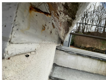
Ingen lufting i bunnen av kledningen.
