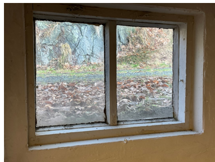
Enkelt glass i deler av kjelleren.
