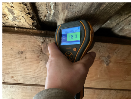
18,3 vektprosent i undertaket.
