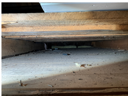
Ingen isolasjon mot kaldtloftet.
