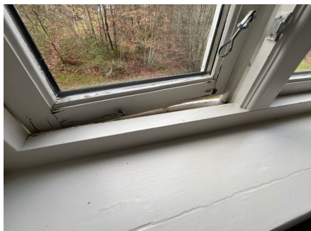
Fuktskader i karmene.
