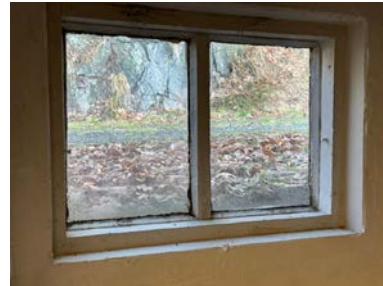
Enkelt glass i deler av kjelleren.
