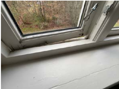
Fuktskader i karmene.
