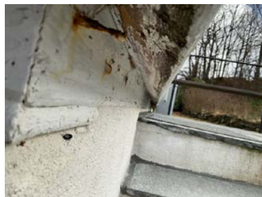
Ingen lufting i bunnen av kledningen.
