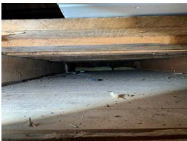
Ingen isolasjon mot kaldtloftet.
