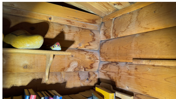
Det er påvist fuktskader i veggkonstruksjonen.
