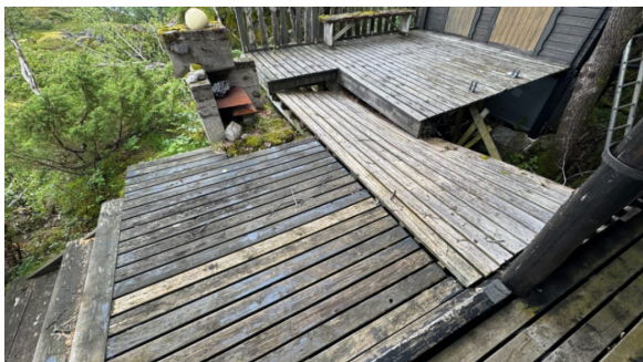
Deler av terrassen er falt ned.
