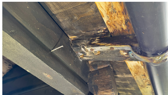
Noe råteskade i taktro/lekter.
