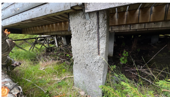
Det er synlig armering på enkelte søyler.
