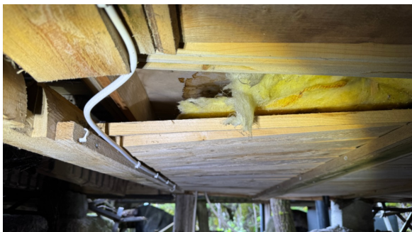
Deler av stubbloftskonstruksjonen har falt ned og etasjeskiller mangler stedvis isolasjon.
