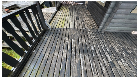
Terrasser er værslitt.
