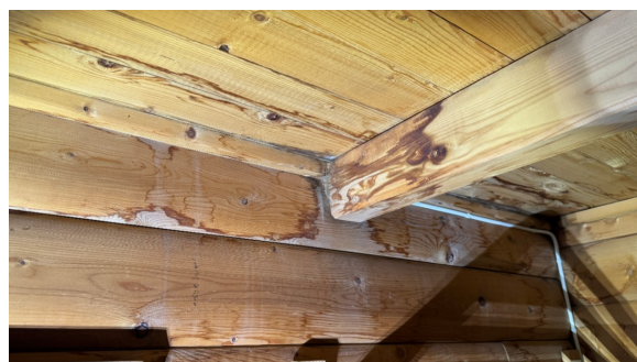
Det er registrert fuktmerker i taket.
