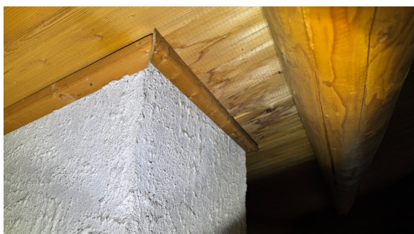
Det er registrert fuktmerker i taket ved pipa.
