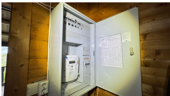
Kontroll av el-skap og kursfortegnelse.
