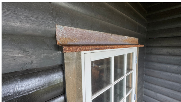
Vindusbeslag har en del rust.
