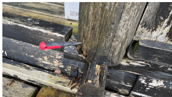
Det er påvist råteskader i bærende tresøyle.
