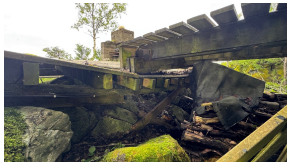
Bærende bjelker for terrassen er råteskadet/knekt.
