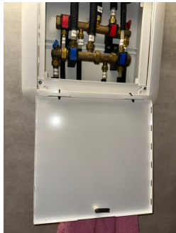
Samleskap med rørkurser og stoppekraner
