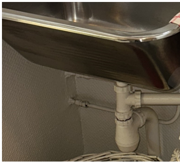
Eldre tilførselsrør av kobber
