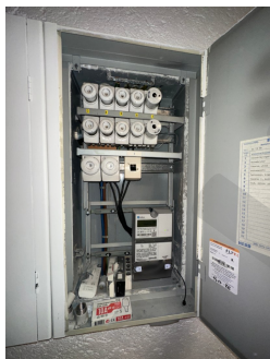
Sikringskap med originale skrusikringer
