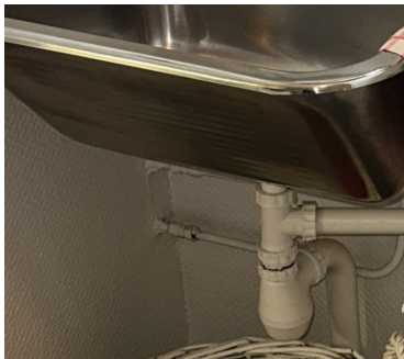
Eldre tilførselsrør av kobber
