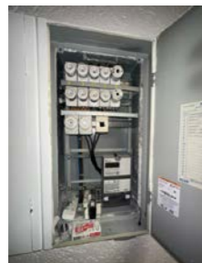
Sikringsskap med originale skrusikringer
