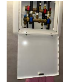
Samleskap med rørkurser og stoppekraner
