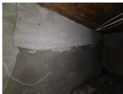
Sprekk i grunnmur sett fra krypkjeller langs støpeskjøt på grunnmur
