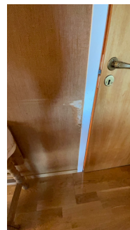
Skade på vegg mot toalett i 1. etasje
