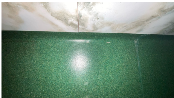
Skade/sprekke i belegget med fare for lekkasje
