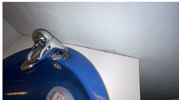
Noe misfarging på fuge/vegg ved servantskap
