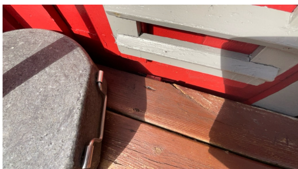
Mangler beslag mellom terrasse og yttervegg
