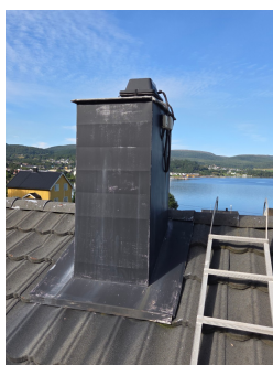
Oversikt pipe, noe slitasje på pipebeslag
