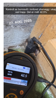
Kontroll av bunnsvill i innforet yttervegg i skap ved trapp. Det er målt 42,5 %
