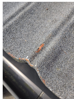
Det er noe synlig rust/avskaling av lakk/overflate på takplater. Plater på nedre del er det synlige skruehull som bør tettes
