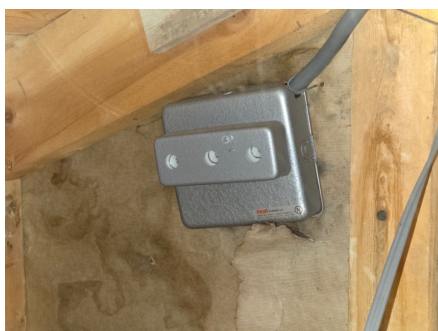
Hovedsikring på kryploft
