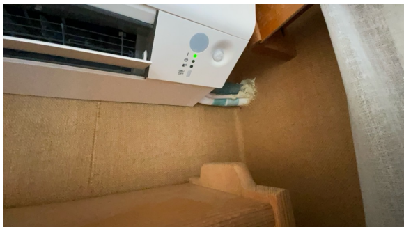
Gjennomføring til varmepumpe er det synlig byggeskum og rør.
