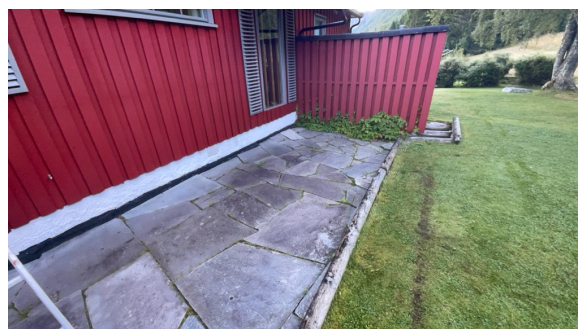
Område ovenfor bolig med manglende fall på terreng
