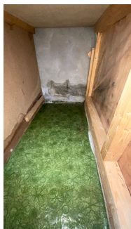
Synlig fukt på bakveggen inne i skap ved trappen
