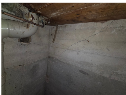
Sprekk i grunnmur sett fra krypkjeller
