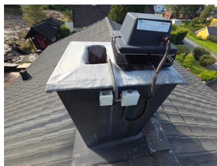
Luftespalte i pipe er åpen. Det bør monteres hatt for å hindre fuktinntregning
