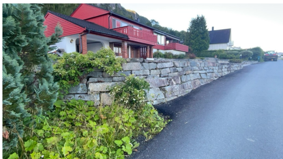
Oversikt. Det mangler rekkverk/annen sikring på forstøtningsmuren(e) ut ifra dagens krav.
