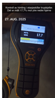
Kontroll av himling/stubbeloft i etasjeskiller krypkjeller. Det er målt 17,7 % mot nedre ytre hjørne
