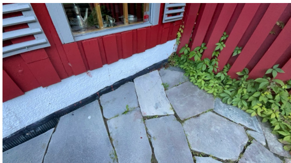
Oversikt, svinnsprekker i puss på mur
