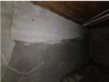
Sprekk i grunnmur sett fra krypkjeller langs støpeskjøt på grunnmur
