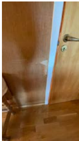
Skade på vegg mot toalett i 1. etasje
