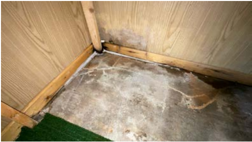
Synlig skade på vegg inn i bod
