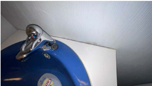
Noe misfarging på fuge/vegg ved servantskap
