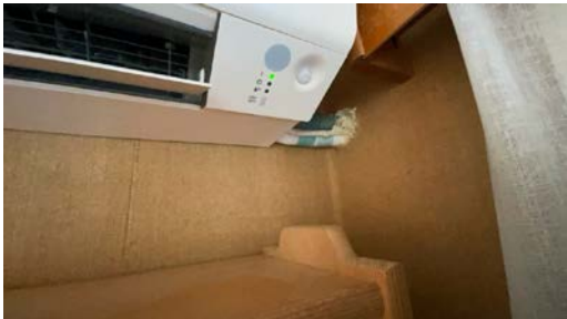
Gjennomføring til varmepumpe er det synlig byggeskum og rør.
