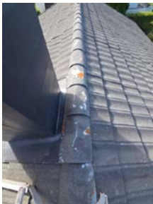
Det er noe synlig rust/avskaling av lakk/overflate på takplater
