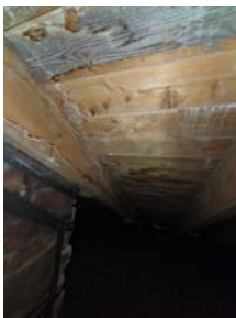
Saltutslag/fuktmerker rundt pipeløp i gjennomføring på tak. Ingen fukt på befaringsdagen
