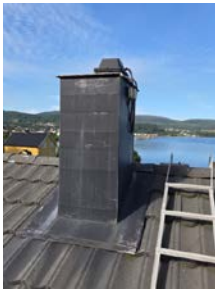
Oversikt pipe, noe slitasje på pipebeslag
