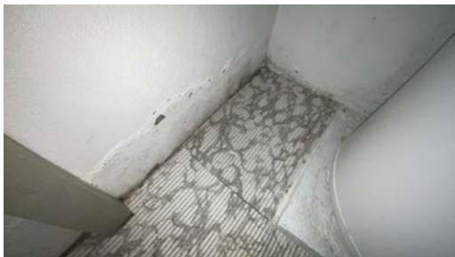
Saltutslag på vegg er synlig ved varmtvannsbereder
