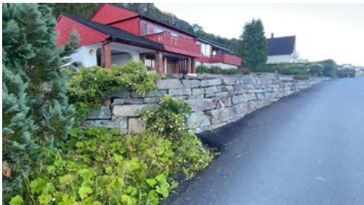
Oversikt. Det mangler rekkverk/annen sikring på forstøtningsmuren(e) ut ifra dagens krav.
