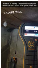
Kontroll av himling/stubbeloft i etasjeskiller krypkjeller. Det er målt 22,4 % mot øvre hjørne under bad
