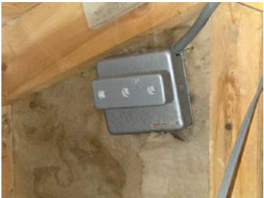
Hovedsikring på kryploft
