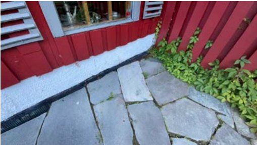
Oversikt, svinnsprekker i puss på mur
