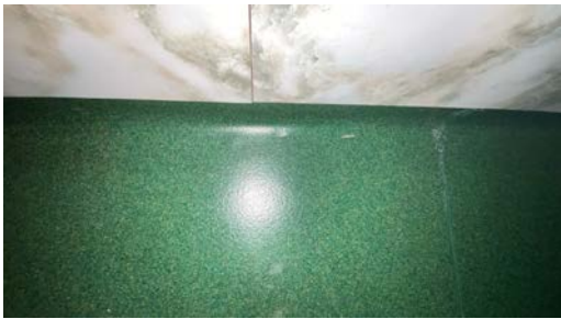
Skade/sprekk i belegg med fare for lekkasje
