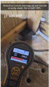
Kontroll av innforet yttervegg på bod hvor det er synlig skade. Det er målt 100 %
