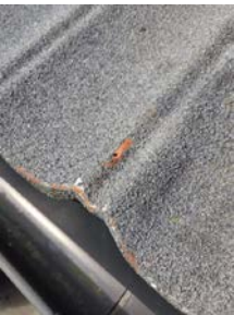
Det er noe synlig rust/avskaling av lakk/overflate på takplater. Plater på nedre del er det synlige skruer hull som bør tettes
