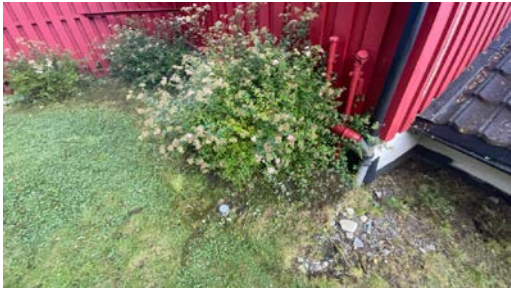
Synlige påfyllingsrør på baksiden ab boligen
