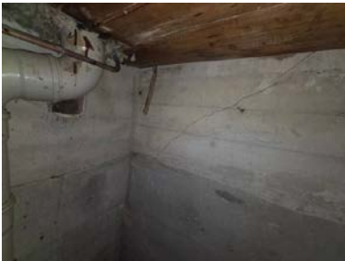
Sprekk i grunnmur sett fra krypkjeller
