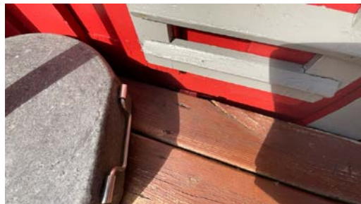
Mangler beslag mellom terrasse og yttervegg
