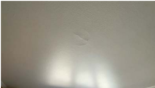
Små skader i himling på stue
