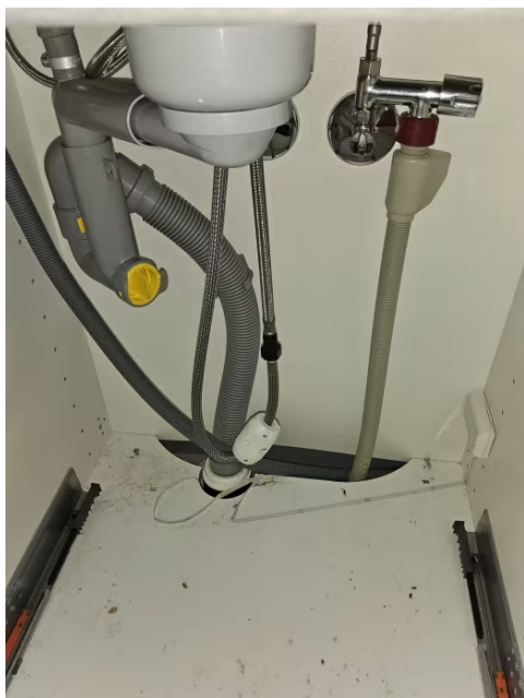
Bilde viser røropplegg under oppvaskkum på kjøkken.
