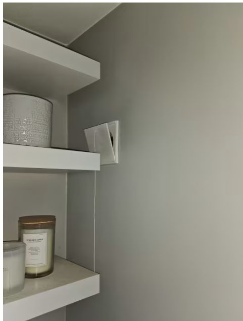
Bilde viser klaffventil på yttervegg.
