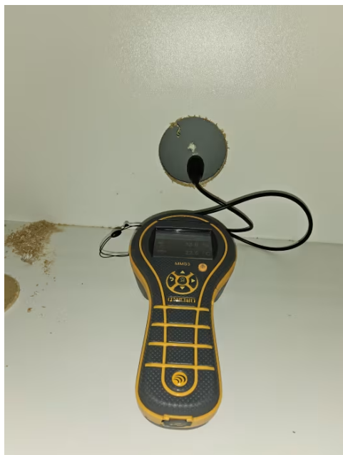
Bilde viser fuktmåling i tilstøtende kjøkken mot bad.
