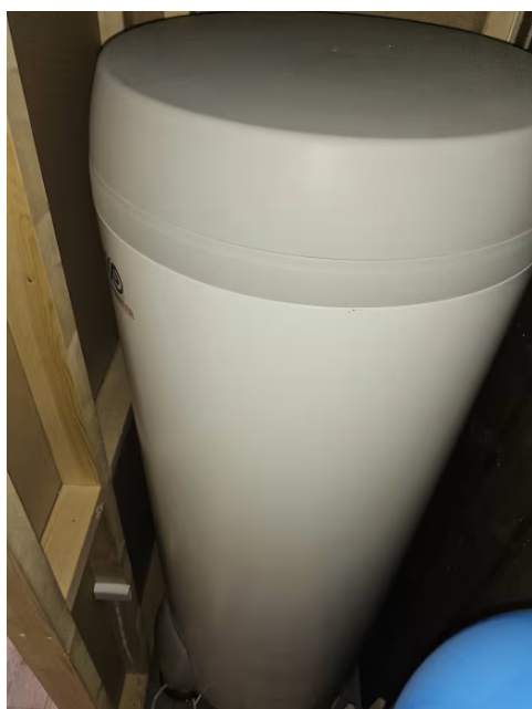
Bilde viser varmtvannsbereder.
