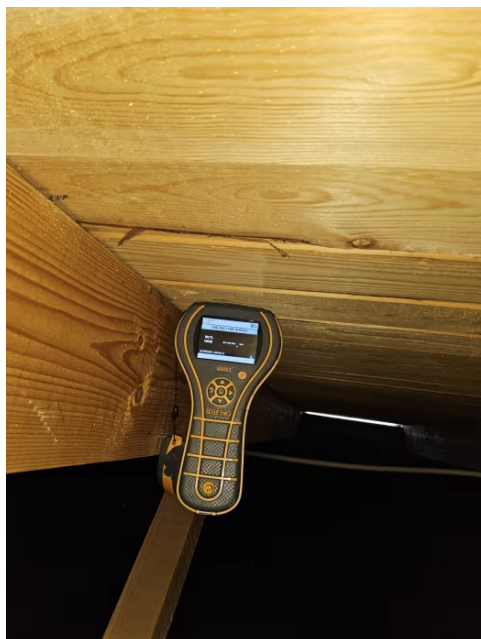
Bilde viser fuktmåling i taktro.
