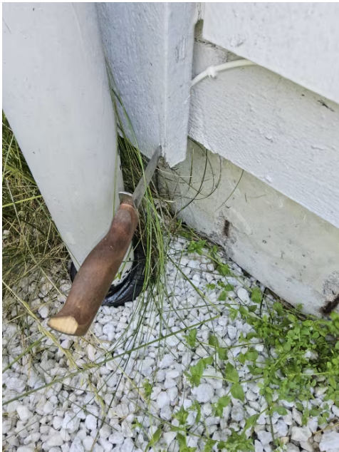
Bilde viser råteskadet hjørnebord.
