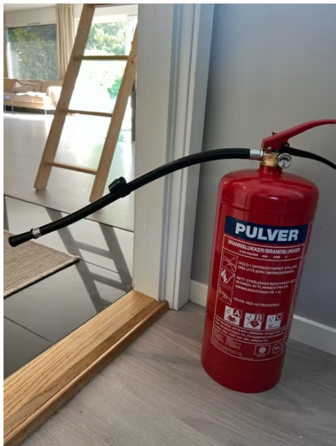
Bilde viser brannslukningsapparat.
