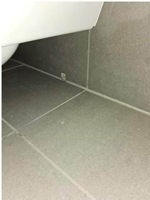
Bilde viser dreneingsspalte for innebygget toaletsisterne.
