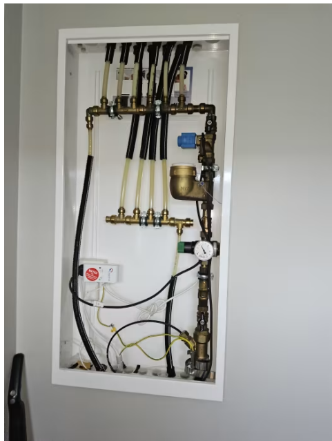
Bilde viser fordelerskap for rør i rørsystem.
