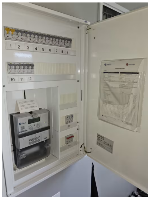
Bilde viser sikringskap.
