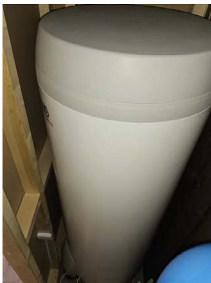
Bilde viser varmtvannsbereder.
