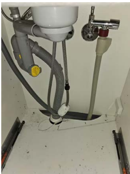
Bilde viser røropplegg under oppvaskkum på kjøkken.
