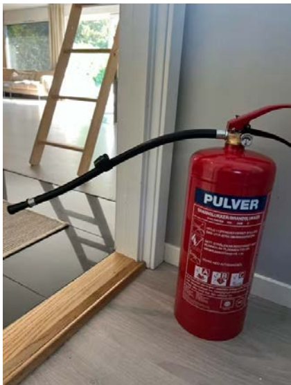
Bilde viser brannslukningsapparat.
