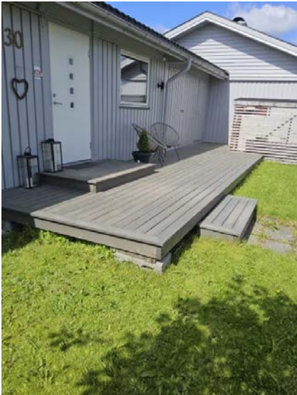
Bilde viser terrasse.
