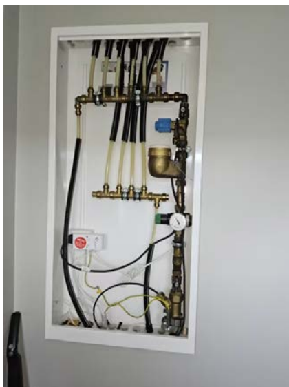
Bilde viser fordelerskap for rør i rørsystem.
