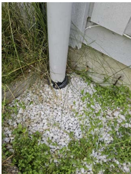
Bilde viser taknedløp ført ned i drensrør.
