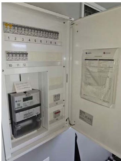
Bilde viser sikringsskap.
