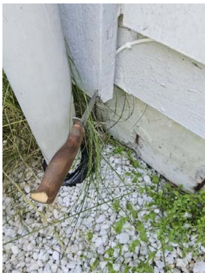
Bilde viser råteskadet hjørnebord.
