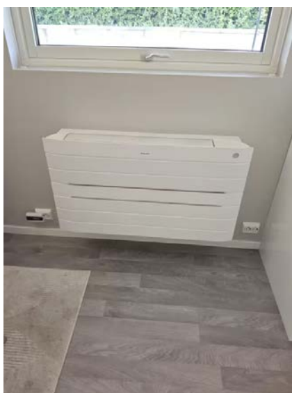
Bilde viser luft til luftvarmepumpe.
