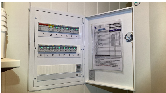
Sikringsskap på teknisk rom.
