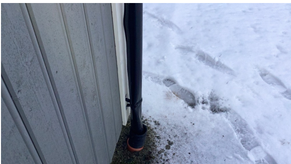
Bulker på nedløp.
