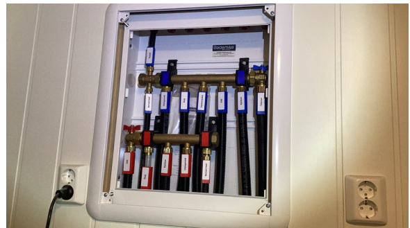
Fordelerskap på teknisk rom.
