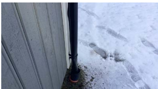
Bulker på nedløp.
