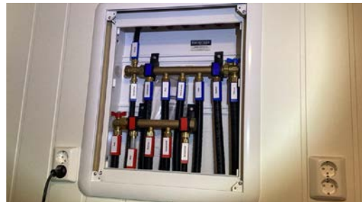
Fordelerskap på teknisk rom.
