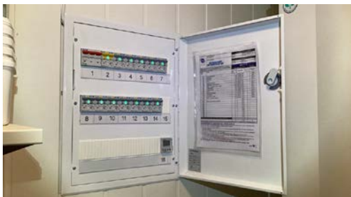
Sikringsskap på teknisk rom.
