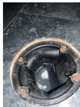
Plastsluk fra byggeår med ruste skruer.
