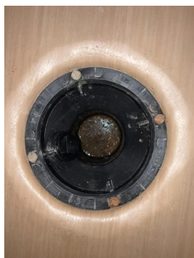
Plastsluk fra byggeår med ruste skruer.
