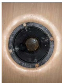
Plastsluk fra byggeår med ruste skruer.
