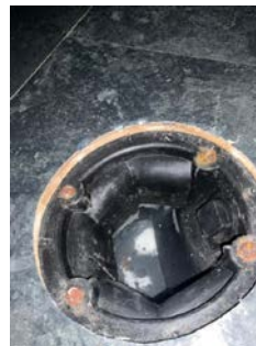
Plastsluk fra byggeår med ruste skruer.
