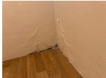
Saltutslag på vegg.
