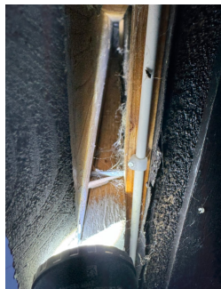
Det er ikke montert musesperre.
