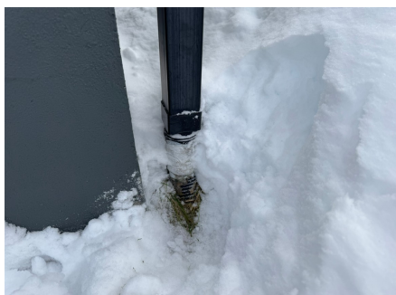
Nedløp ført ned i bakken i rør.
