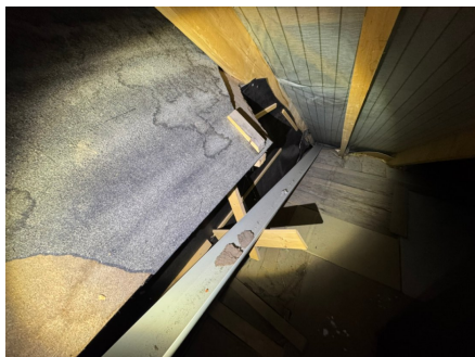
Takrennesystem fra hovedtaket.
