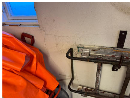
Eksempel på sprekk.
