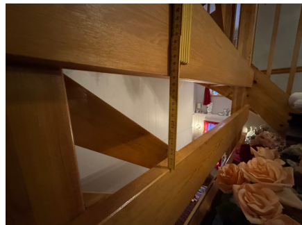
Eksempel på for store åpninger i trappen.
