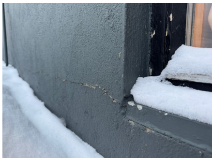
Eksempel på sprekk i grunnmuren.
