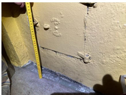
Manglende ildfast plate under sotluken og for liten avstand til brennbart materiale. Ildstedet i stuen.
