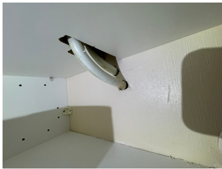
Eksempel på utette rørgjennomføringer.
