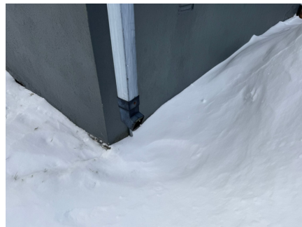
Nedløp avsluttet over terreng med utkaster.
