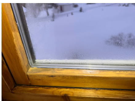
punktert vindu. Tegn til innvendig kondensering.
