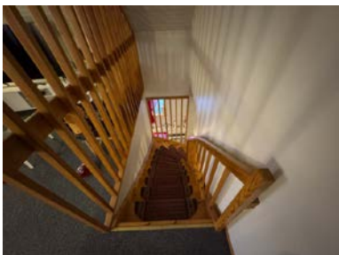
Manglende håndløper i trappen.
