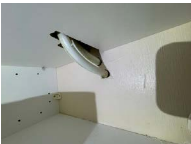
Eksempel på utette rørgjennomføringer.
