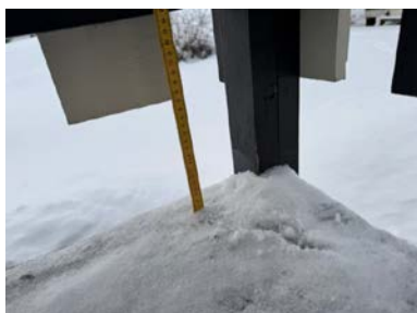
Åpninger i rekkverket.
