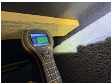
Fuktmåling i krypekjelleren.
