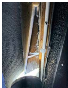
Det er ikke montert musesperre.
