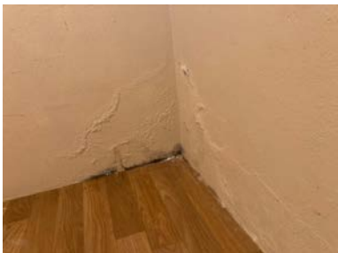
Indikasjoner på at drenering/tettesjikt har begrenset effekt.
