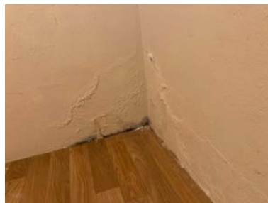
Saltutslag på vegg.
