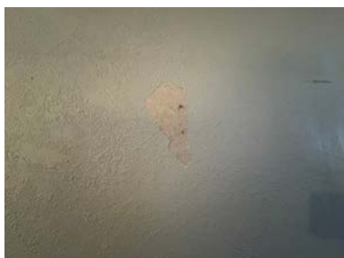
Eksempel på skade som er utover normal slitasjegrad.
