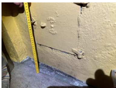
Manglende ildfast plate under sotluken og for liten avstand til brennbart materiale. Ildstedet i stuen.
