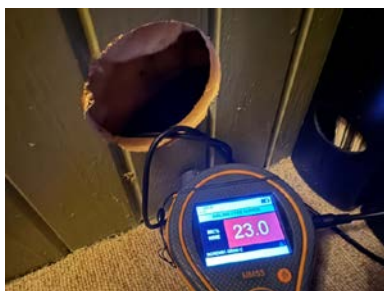
Fuktmålingen viser 23 vektprosent.
