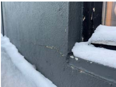
Eksempel på sprekk i grunnmuren.
