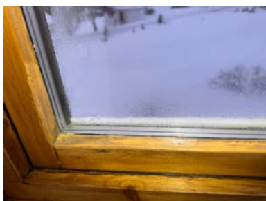
punktert vindu. Tegn til innvendig kondensering.
