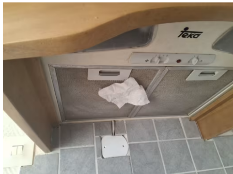
Kjøkkenventilator er testet med papir.
