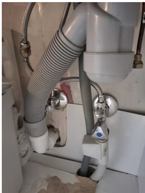
Synlige avløpsrør av plast i leiligheten.
