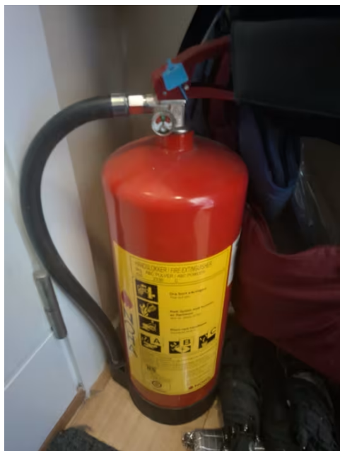
Brannslukningsapparat er plassert i entré.
