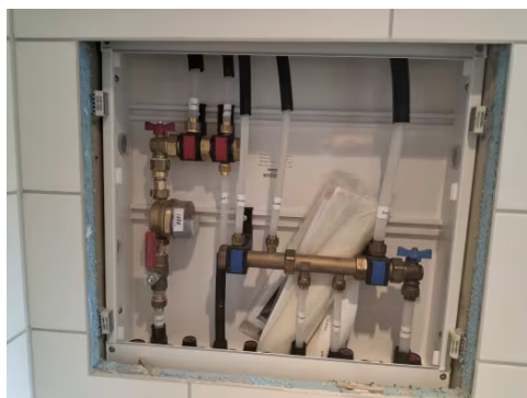
Fordelerskap for rør-i-rør med hovedstoppekraner er plassert på bad.
