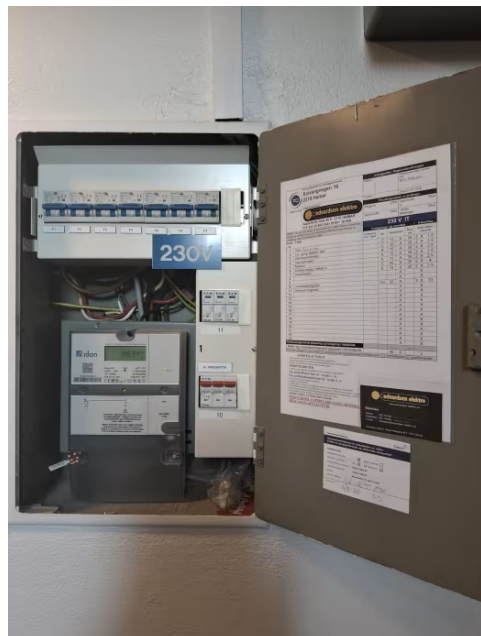
Sikringsskap er plassert i felles trappegang.
