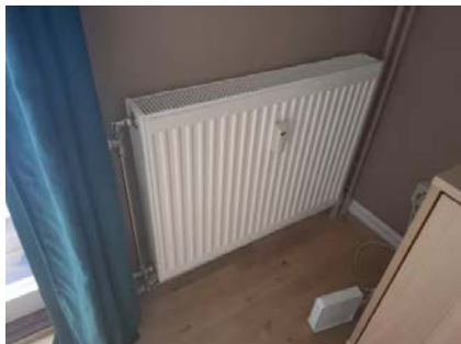
Radiatorer er oppgradert siden opprinnelig byggeår.
