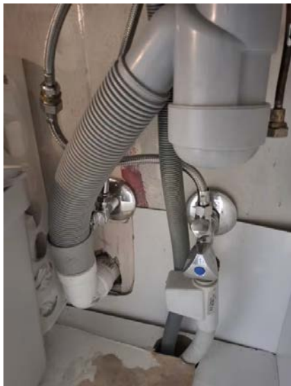
Synlige avløpsrør av plast i leiligheten.
