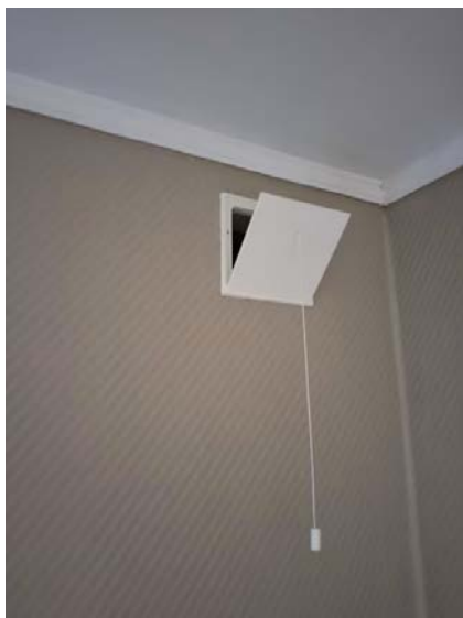
Naturlig ventilasjon i leiligheten.
