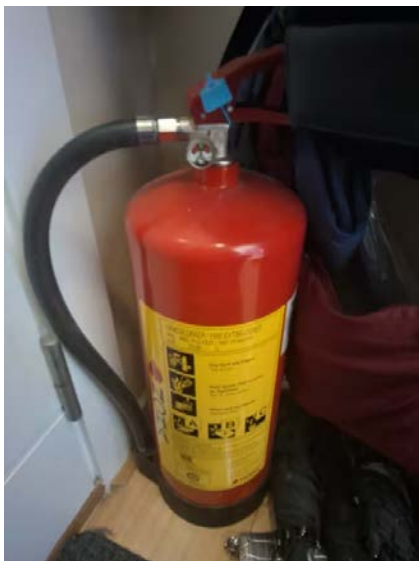
Brannslukningsapparat er plassert i entré.
