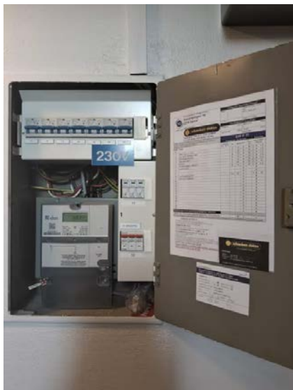
Sikringsskap er plassert i felles trappegang.
