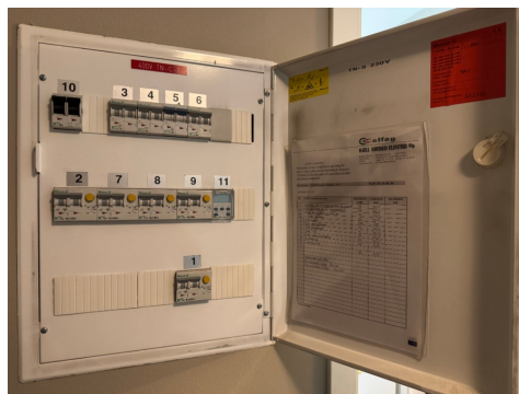
Sikringsskap i entre/gang.
