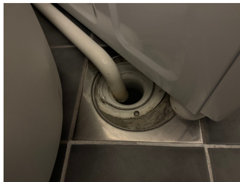
Plastsluk i gulv v/ vaskemaskin.
