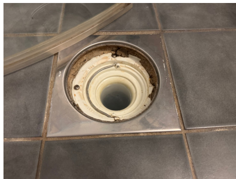
Plastsluk i dusjsone.
