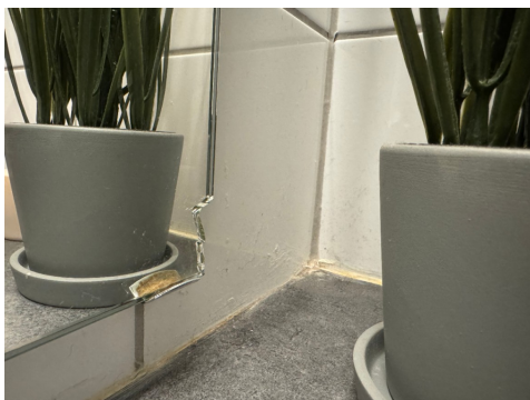
Skade på kant av speil.
