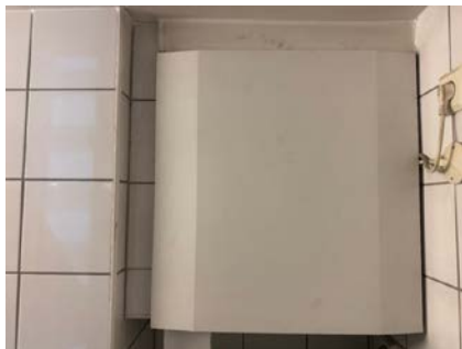
Luftbehandlingsaggregat på bad.
