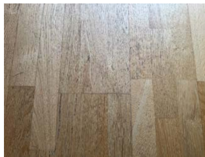
Slitasje/striper i parkettgulv i stue/kjøkken.
