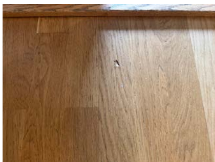
Hakk/bruksmerke i parkettgulv i entre/gang.
