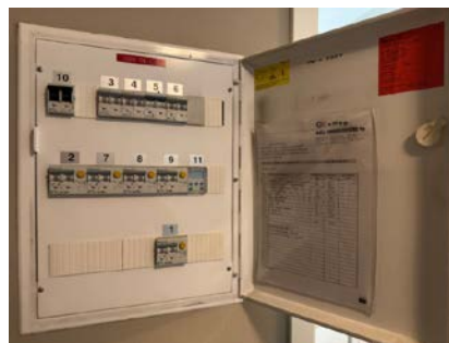
Sikringsskap i entre/gang.
