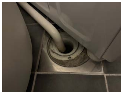
Plastsluk i gulv v/ vaskemaskin.
