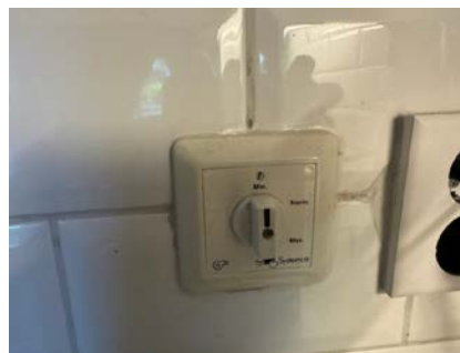
Bryterpanel i stue/kjøkken. Bør stå på maks effekt v/ dusjing.
