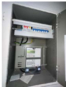
Sikringsskap med automatsikringer.
