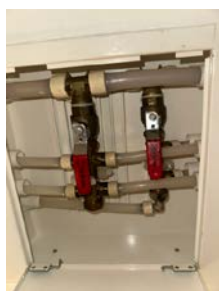
Samleskap med rørkurser og stoppekraner
