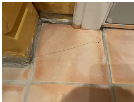
Sprekk og bom (hullrom) i flis
