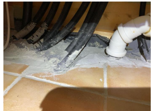
Ufagmessighet og synlig tettesjikt etablert rett på organisk materiale
