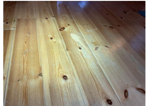
Slitasje på gulvoverflate.
