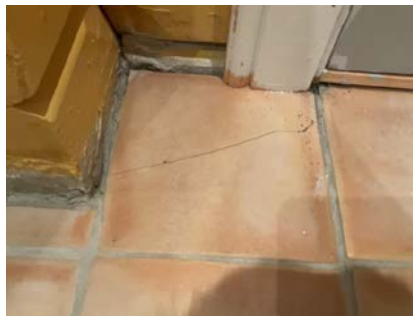
Sprekk og bom (hullrom) i flis
