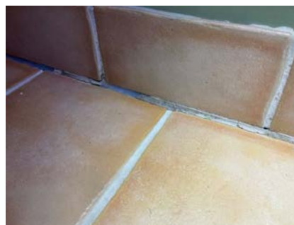
Sokkelflis limt rett på laft og overgang fluser har sementbasert fugemasse og dels ettermontert silikon der fugemasse har løsnet
