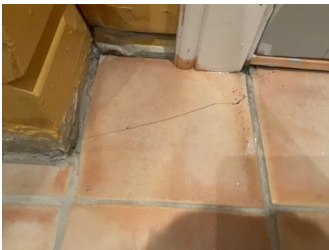
Sprekk og bom (hulrom) i flis
