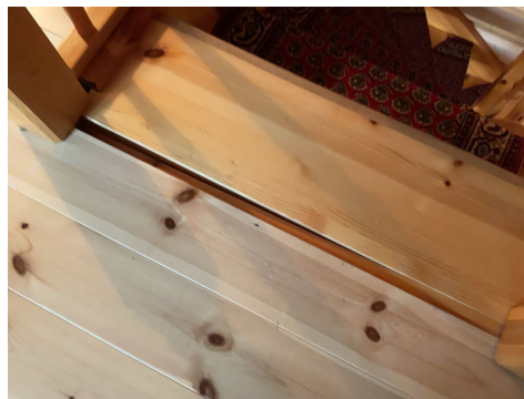
Glippe med nedsunket list
