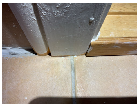
Sprekk i flishjørne
