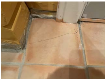
Sprekk og bom (hullrom) i flis
