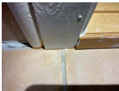
Sprekk i flishjørne
