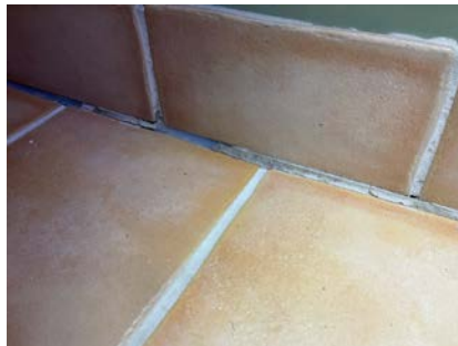
Sokkelflis limt rett på laft og overgang fluser har sementbasert fugemasse og dels ettermontert silikon der fugemasse har løsnet
