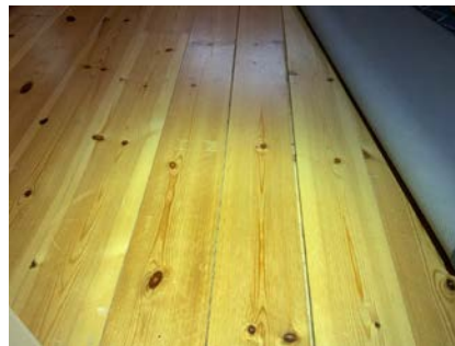
Glippe i enkelte skjøter, trolig lagt flytende og knirk er registrert.
