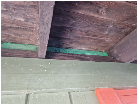
Luftespalte ved raft.
