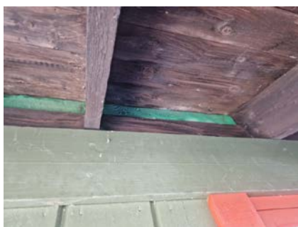
Luftespalte ved raft.
