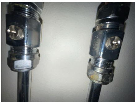
Stengeventiler i kjøkkenbenk.
