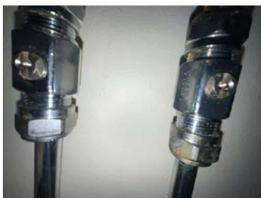
Stengeventiler i kjøkkenbenk.
